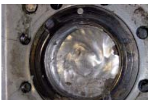
Verschleiß der Schieberplatte
