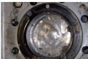
Verschleiß der Schieberplatte
