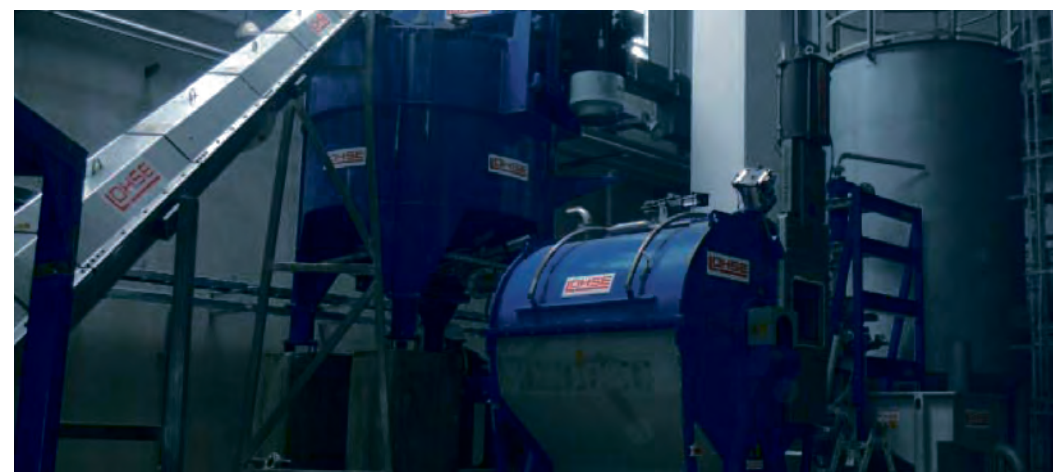
Abfall-Nassaufbereitungsanlage in Seoul (Südkorea)
